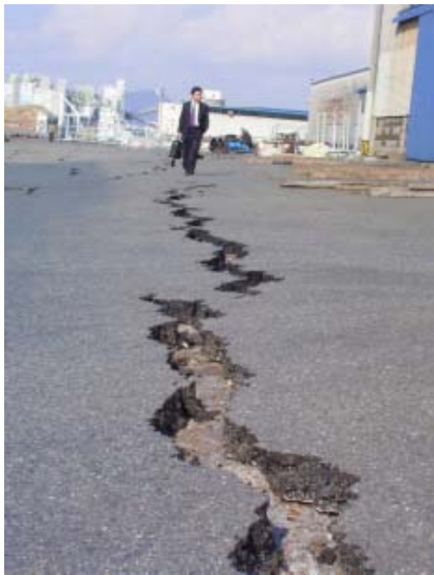
Fig.11 中央埠頭 地割れ
