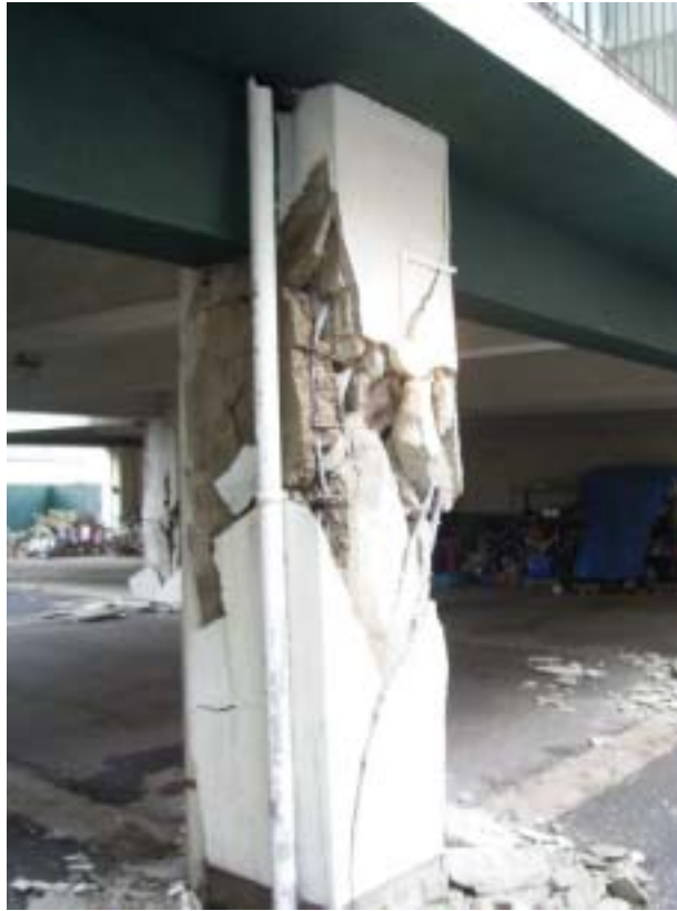
Fig.1 ピロティー形式 1階柱被害（損保ジャパン・リスクマネジメント撮影）
