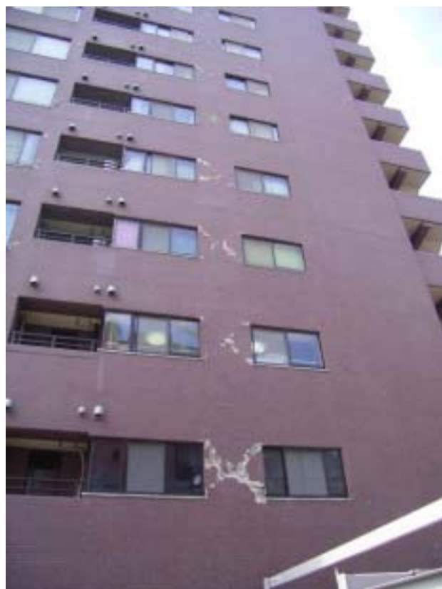
Fig.15 大名 東面被害
