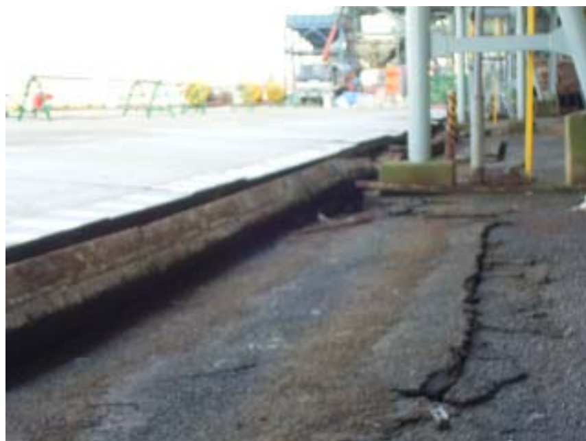
Fig.13 須崎埠頭 沈下
