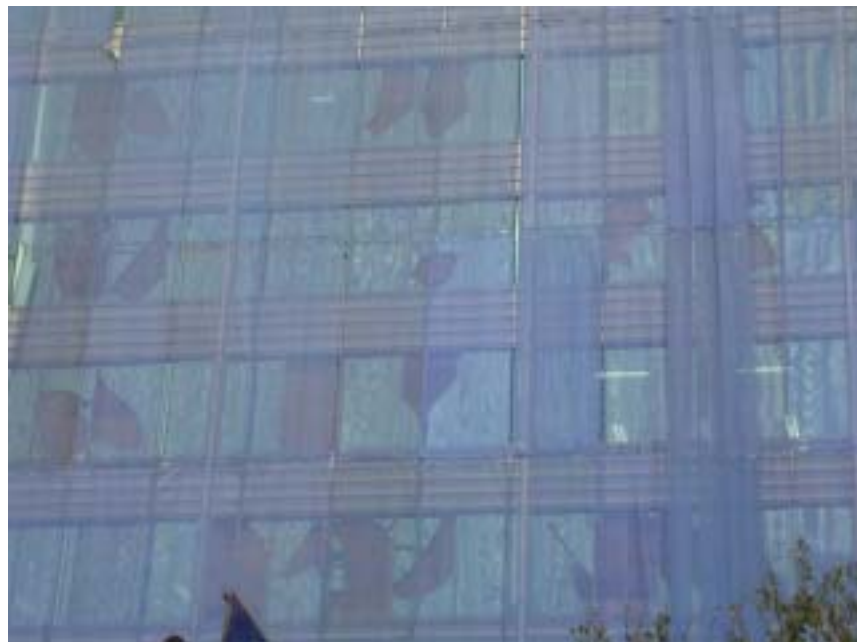
Fig.19 天神 窓ガラス被害
