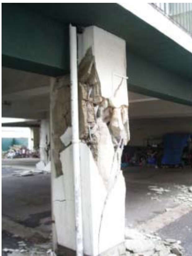
Fig.14 大名 ピロティー被害
