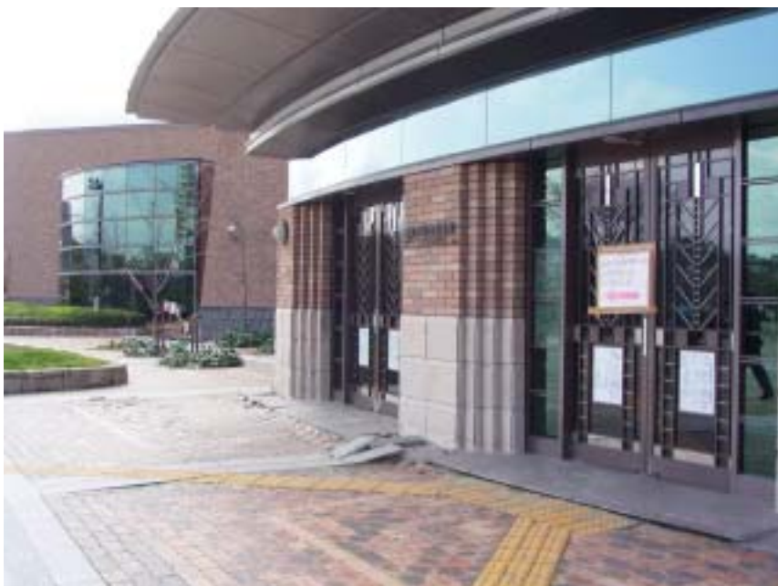
Fig.10 市立図書館 建物周囲の陥没
