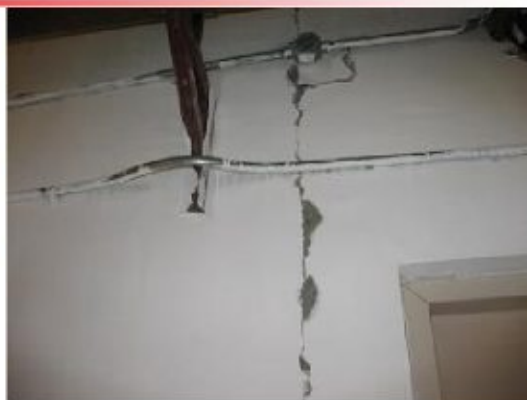
建物内部クラック
