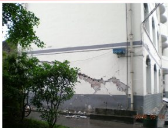
建物の被害状況
