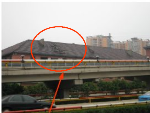
屋根の損壊状況
