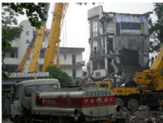
ビル倒壊状況
