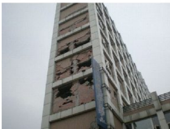
レンガ壁の損壊状況
