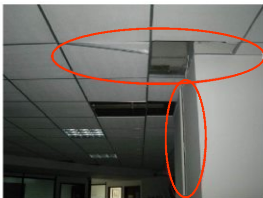
吊り天井タイルの落下
