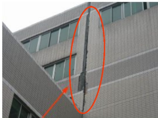
建物ジョイント部の亀裂発生状況
