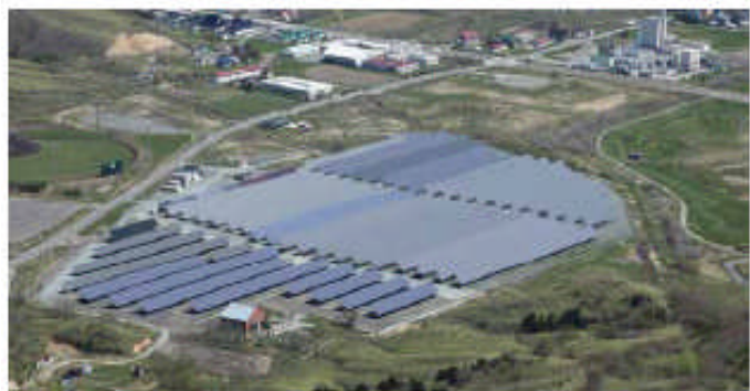
写真 稚内メガソーラー発電所（約5MW） 5
